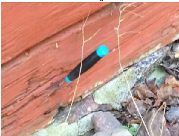
Exempel på rötskador i bottenstock
