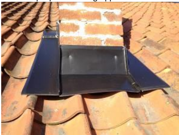
Bristfällig kringtätning runt skorsten, plåtbeslag täcker dåligt över takpannorna
