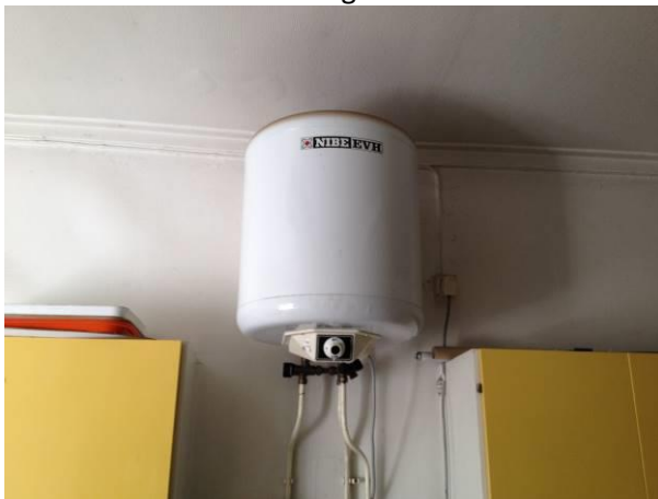
Varmvattenberedare i kök
