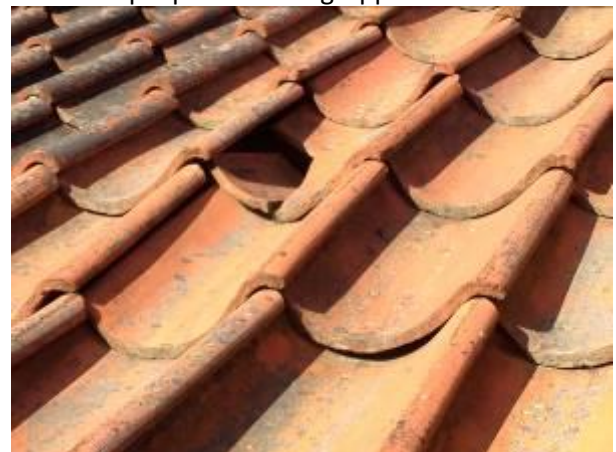
Exempel på spruckna takpannor
