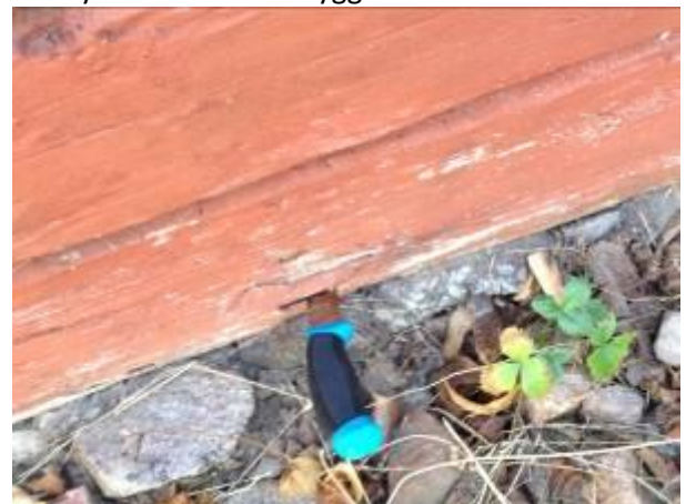
Exempel på rötskador i bottenstock
